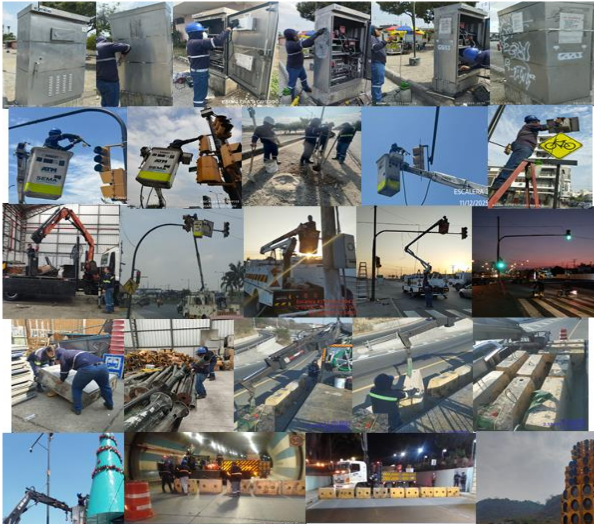
Ilustración 14 Evidencias de los mantenimientos semafóricos año 2025
